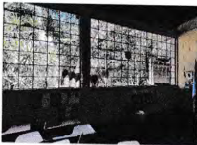
Foto 9: Mantenimiento a estructura de soporte de ventana, presenta oxido
