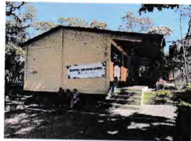
Foto 8: las tijeras de los mojinetes se encuentran oxidadas, falta de mantenimiento, falta de canal para agua pluvial
